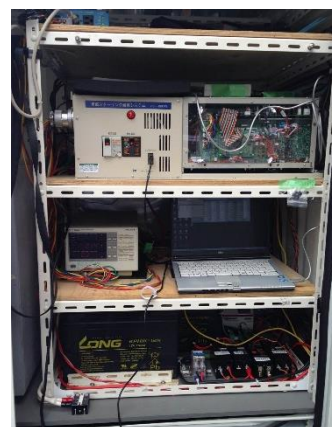
コンバータ(上段), パワーメータ とノートPC(中段), バッテリーと ソーラー発電コントローラ(下段)
