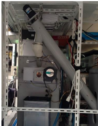
燃料フィーダ(右下から 左上へ), 燃焼炉(中 央), インバータ(右上)
